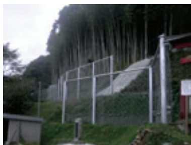
斜面に設置した事例
