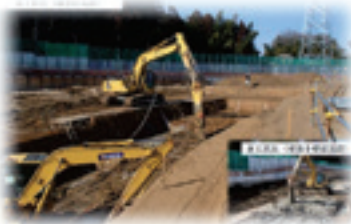
道路盛土の残留沈下、変形防止
