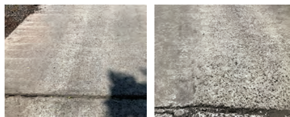
PVA 繊維補強 普通コンクリート b) 11年経過時(2024年)
