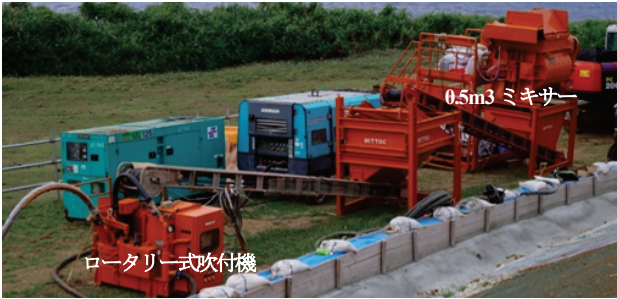
図二 0.5m 3 の吹付・生育基盤製造プラント
