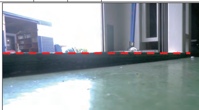
地盤沈下の為倉庫入口に約8 c mの段差が発生
