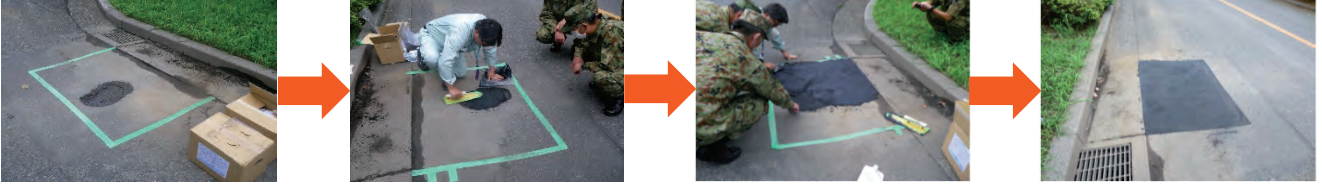
【事例2】 陸上自衛隊 鯖江駐屯地 : 正門アスファルト→コンクリートの段差修正
